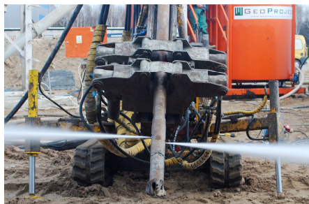
STRUMIENIE INIEKUJĄCE W TRAKCIE PRACY
